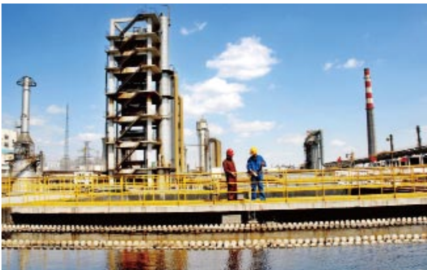
太原煤气化公司第二焦化厂生化处理系统
