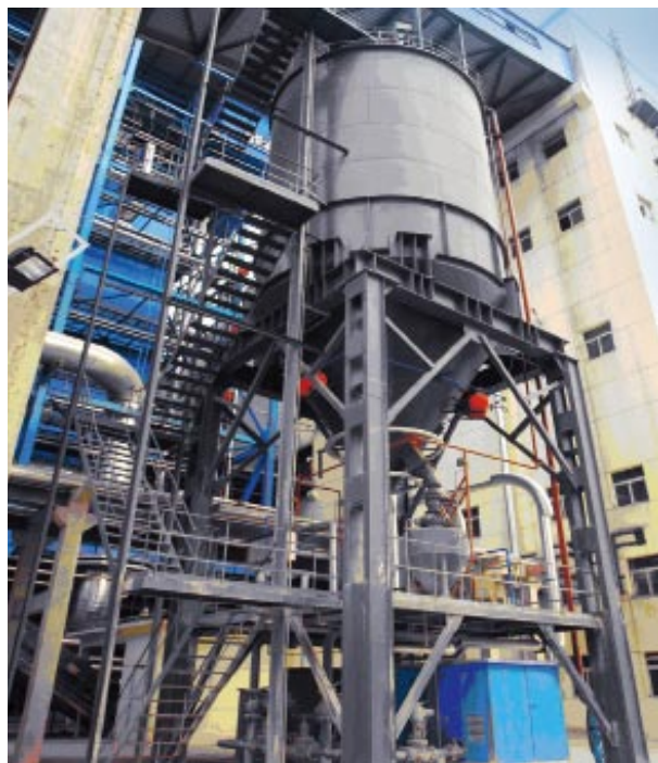
热电厂脱硫设施
