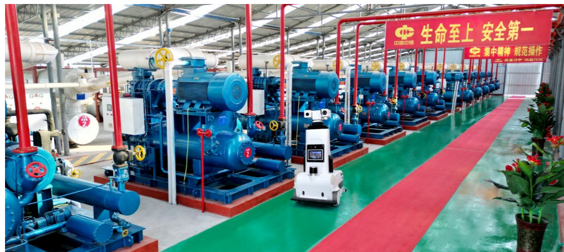
建设集团特凿公司设计研发首座智能化冻结站及首个冻结站智能巡检机器人
